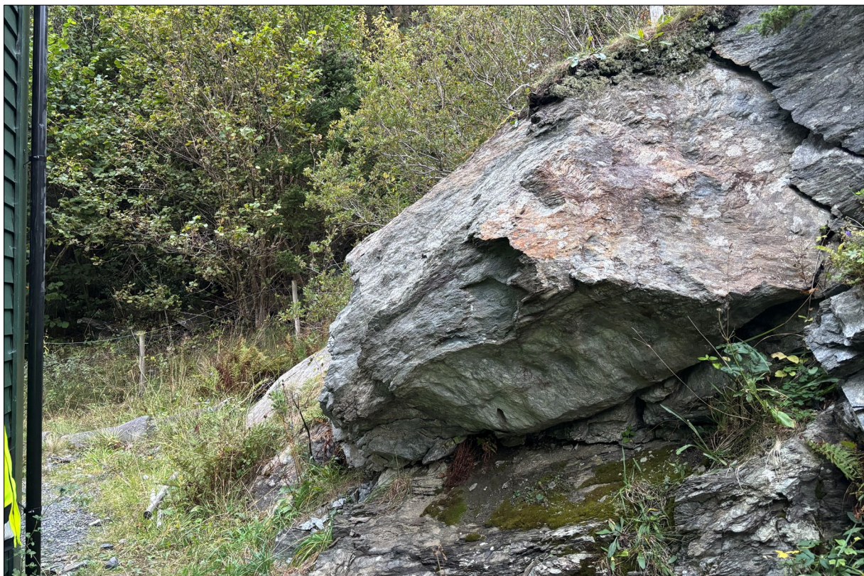
Figur 8: Bildet viser ustabil fjellparti av skifrig metagråvakke ved nordlige hjørne på huset i kartlagt området. Infopunkt 1.
