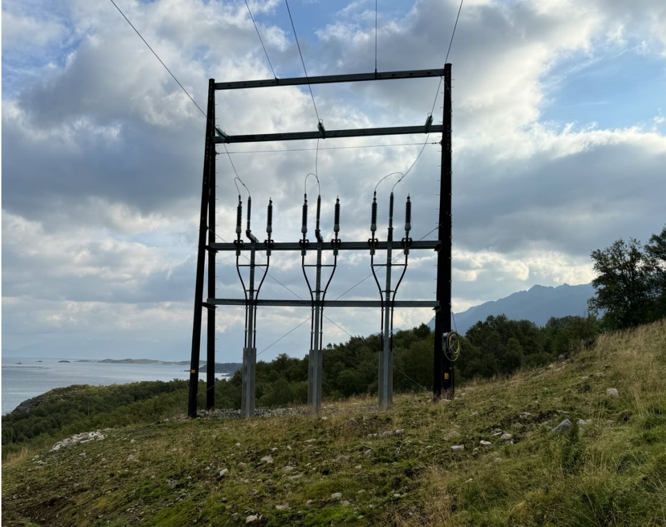
Figur 4: Eksempel på kabelendemast for 132 kV kabel. Her er fra landtak i Hadsselfjorden.
