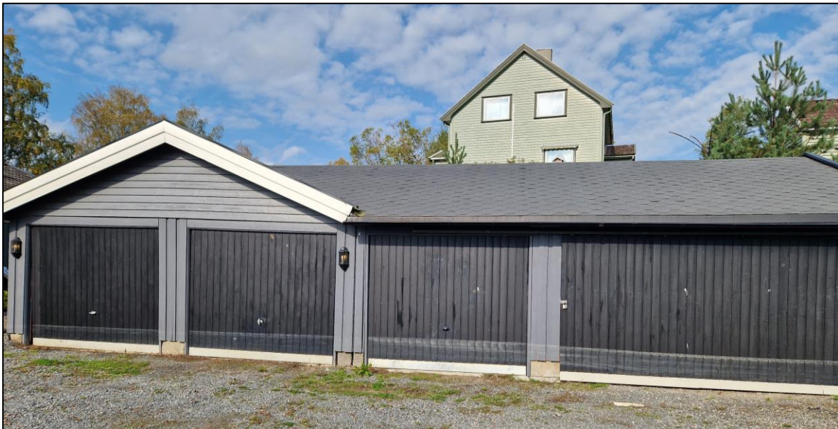
Figur 5 – Garasje på Stølandet 40 med synlig høyvannslinje etter oversvømmelse (23.09.2024)
