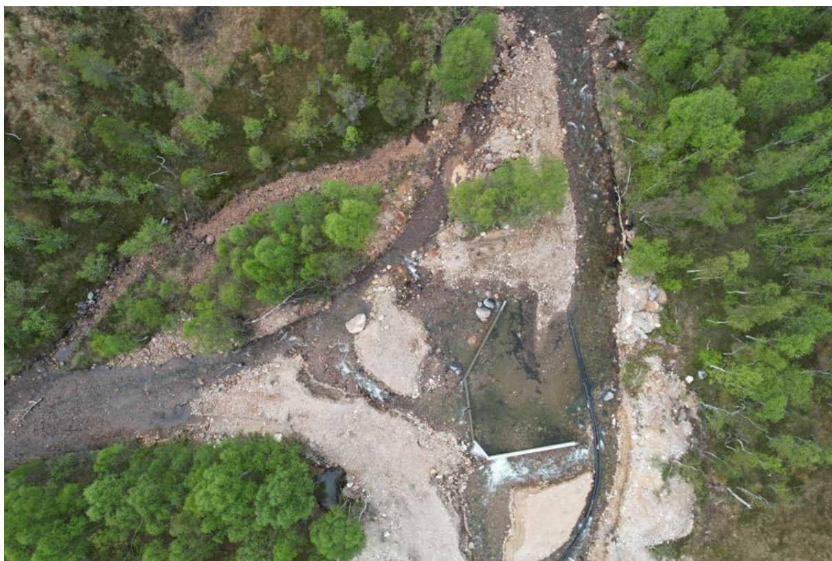
Figur 3. Eksisterende betongterskel med vannuttak. Området er i dag preget av erosjon.
