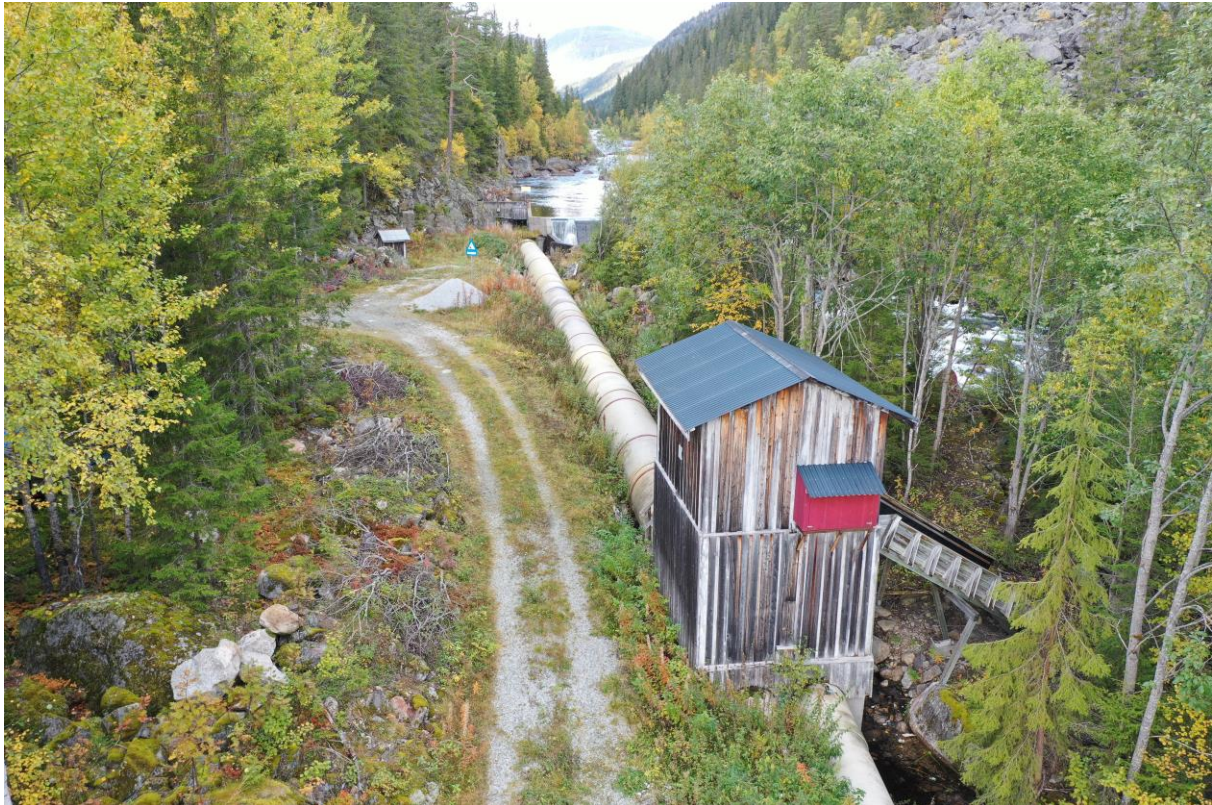
Bilde 3. Trykkrøyra frå dam til svingesilo med finrister og overgang til to rør.
