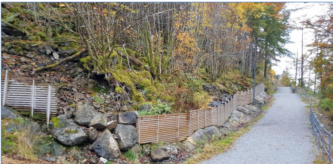
Figur 5: Over Løvtien er det observert løsmasser som består av urmasser, spesielt i terrenget sørvest for tomten. Løsmassene støttes opp av sognemurer som er fundamentert på berg rett over veien.
