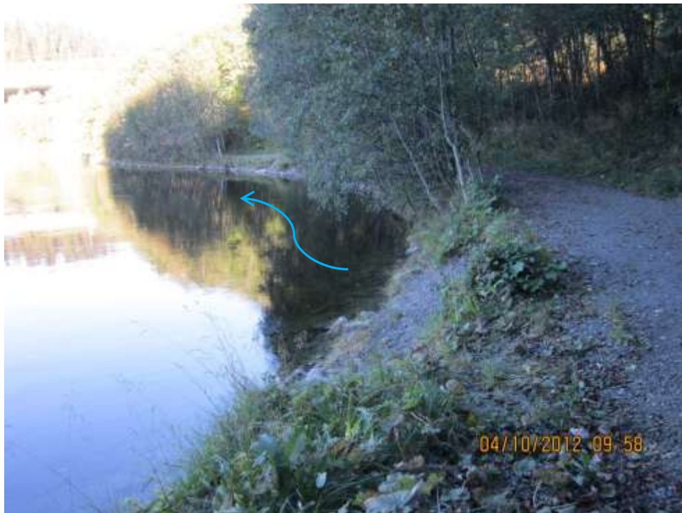
Bilde 2: Sikringen er slitt, og tydelig dårlig fot på deler av strekningen.
