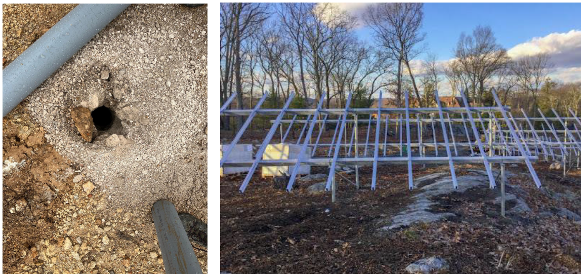
Figur 10: Eksempel på montasjestruktur fundamentert i fjellgrunn (c) Greenstat Solar Solutions
