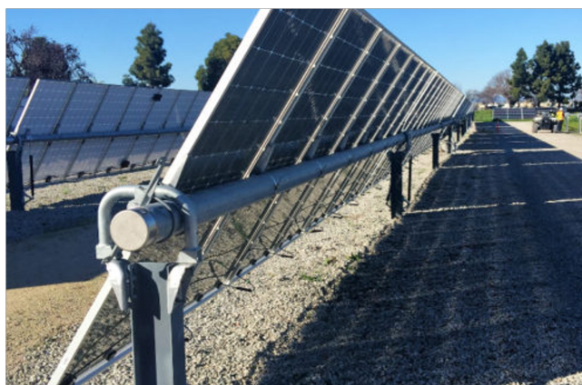
Figur 9: Eksempel på en-akse rotasjonsinstallasjon med dobbeltsidige (bi-facial) paneler
