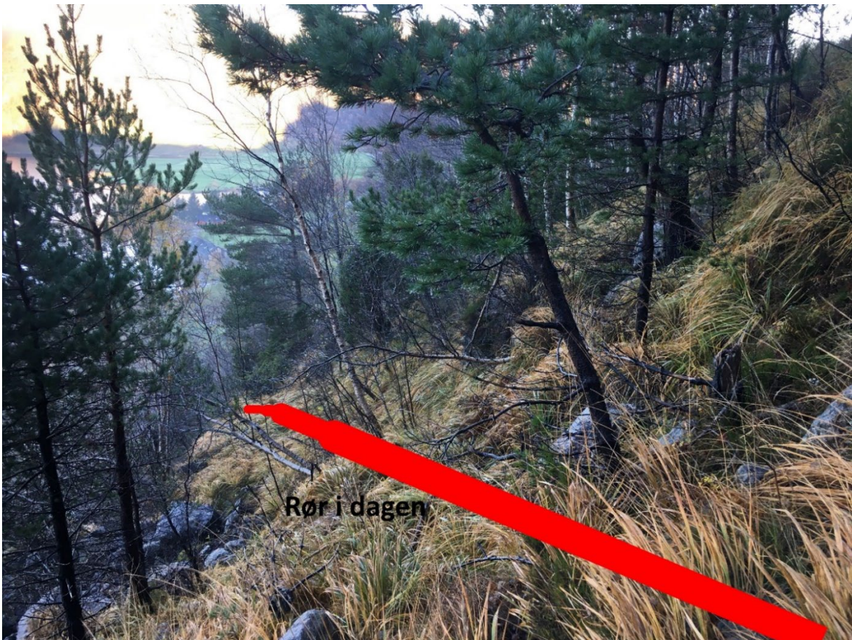
Fig.8: Øvre del av vannvei – rør i dagen
