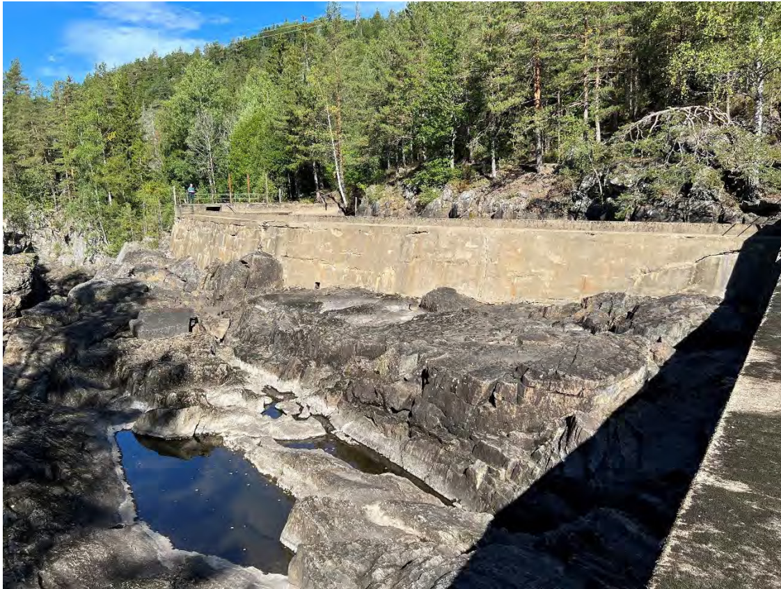
Figur 9 Kanal på luftside sett frå dam. Dammen har er truleg utført i stadleg stein med eit tynt lag betong for vassetting. Lokal stein er også brukt i tilslaget i betongen. Strukturen i overflata er oppsprukken og det er spottar med raud farge frå rusta armeringsjern. Påstøyp kant på toppen vart utført med forskalingskassetar.
