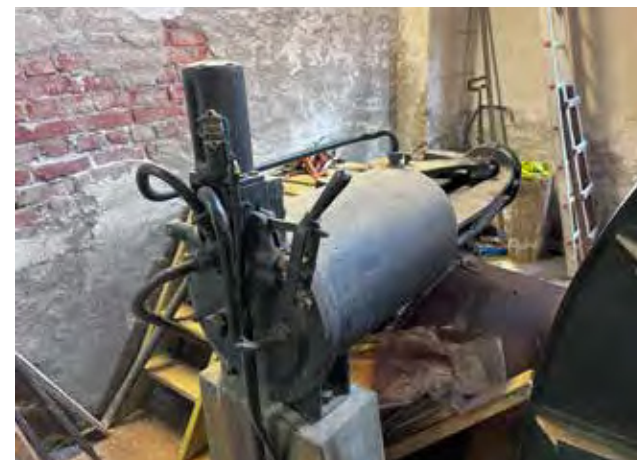
Hydraulisk ventil for styring av inntaksventil på turbinrør.
