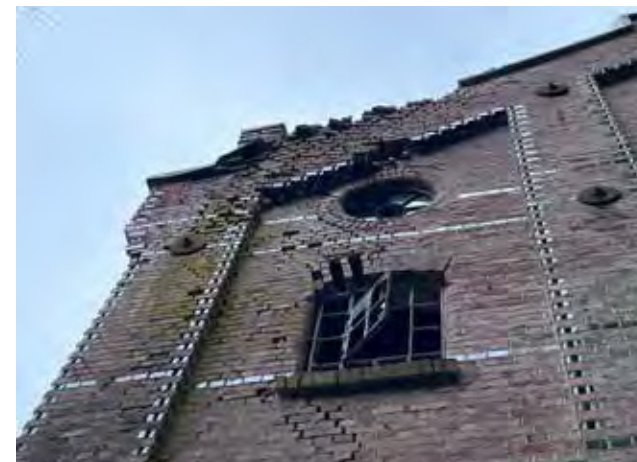
Sliperiet: Detalj av fasade sør-øst. Store skader i øvre del.
