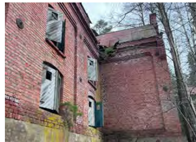
Tørkeriet: Fasade sør-øst. Skader i gradrenne og gesims.
