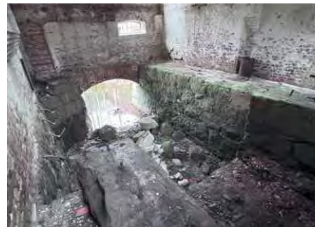
Sliperiet: Interiør 1. etg. Turbinrom.
