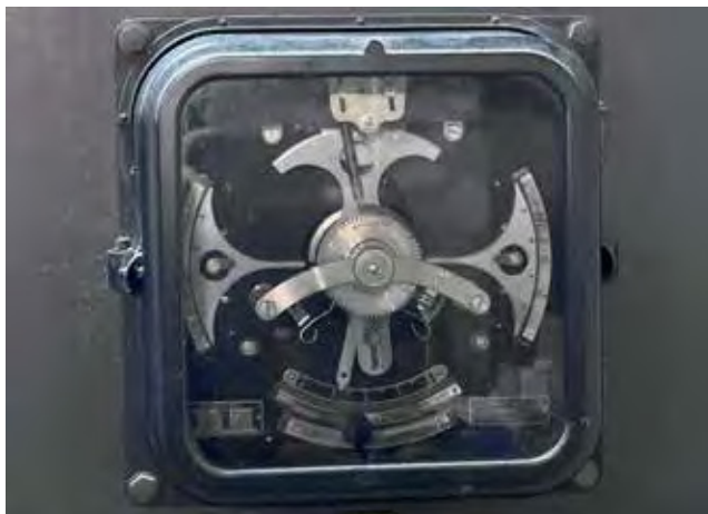
Detalj av gammelt styringskap.
