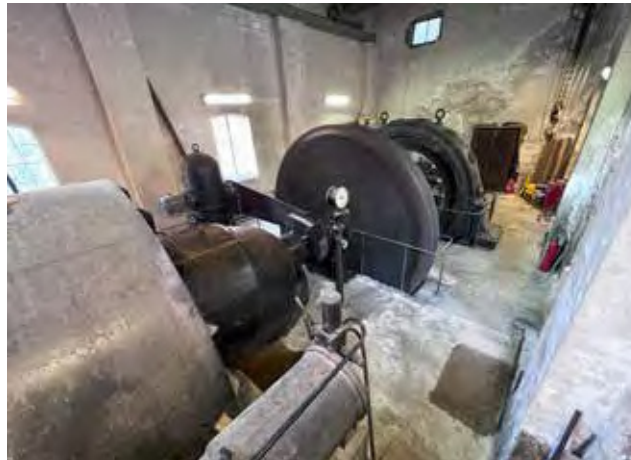
Turbin, svinghjul og generator.
