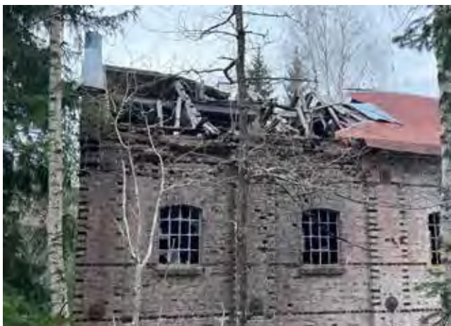
Sliperiet: Store takskader på fasade nord-øst.
