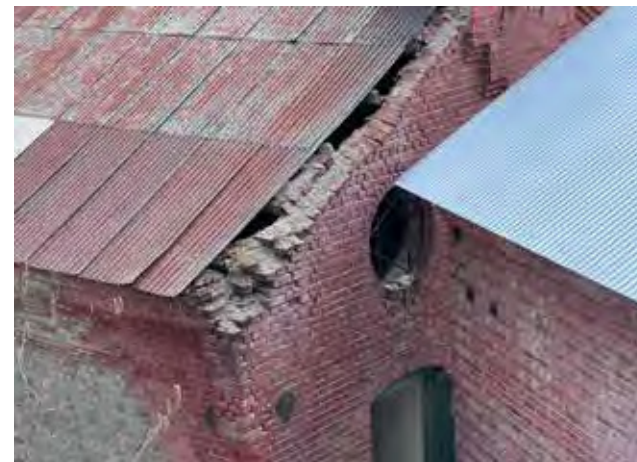
Tørkeriet: Store skader i gesims på hjørne mot sør-vest.
