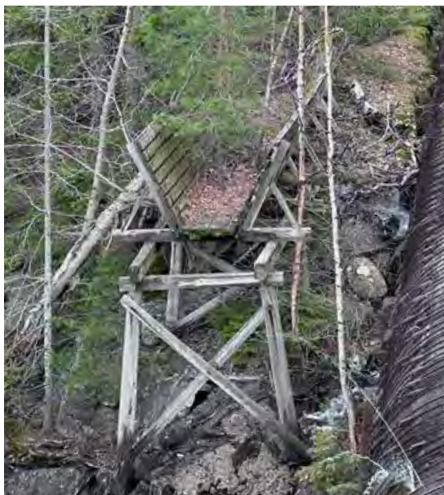
Tømmerrenne er kappet av på enkelte steder.
