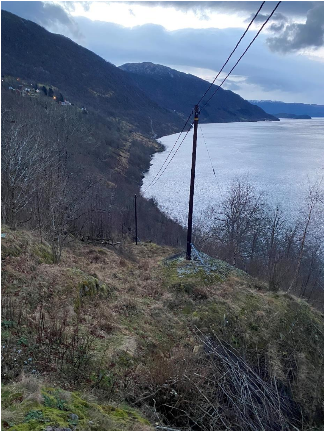
Viser øvre trase for 1000V ledning ned mot sjøen. Denne skal erstattes med en 22 kV hengekabel
