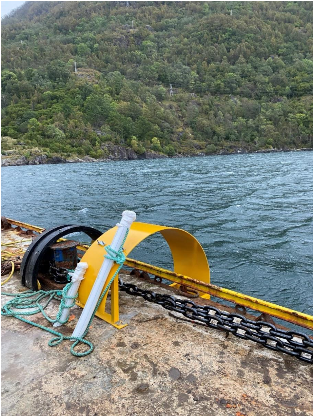
Viser strekkavlaster til sjøvannskablene inn på flåten, slik dagens kabler kommer inn. Bilde er tatt før kablene ble montert.
