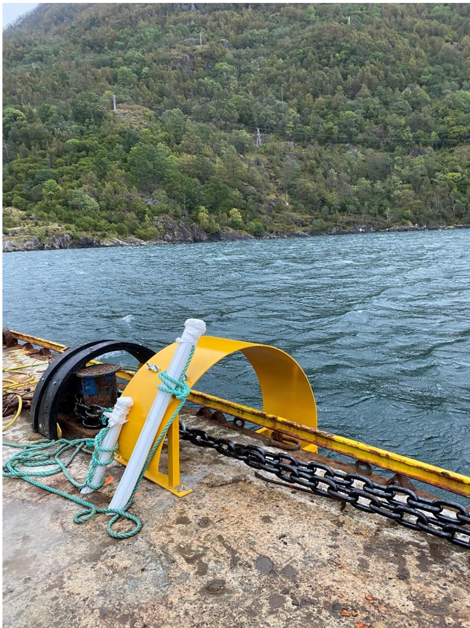
Viser strekkavlaster til sjøvannskablene inn på flåten, slik dagens kabler kommer inn. Bilde er tatt før kablene ble montert. I bakgrunnen ses eksisterende nettstasjon, ledningstrase og eksisterende tilkoblingspunkt
