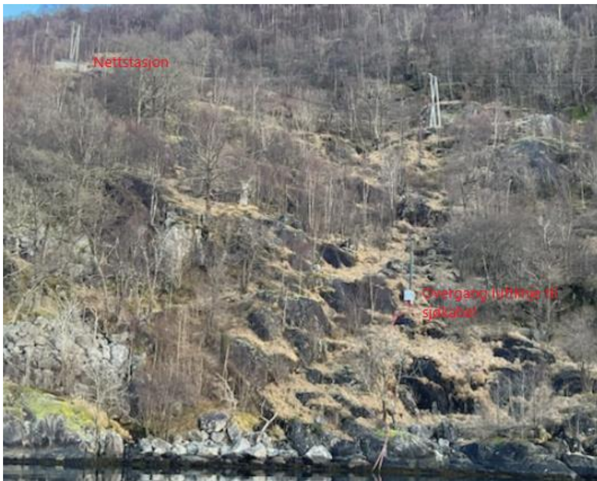
Bilde av nettstasjon, sjøkabel og luftlinje sett fra sjøsiden.
