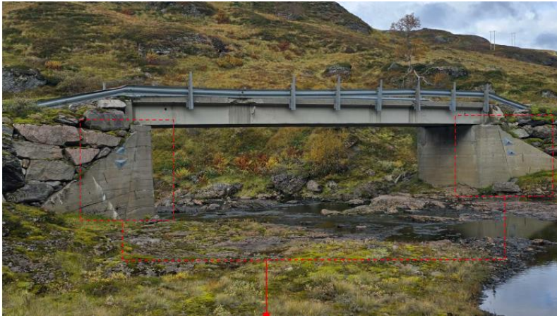
Skader på rekkverk, bru og landkar er planlagt utbedret.
