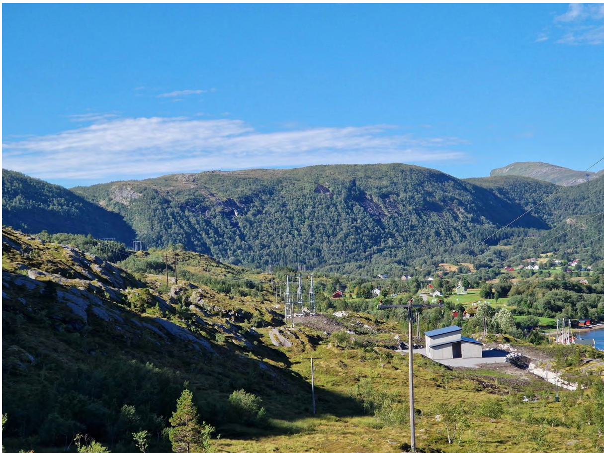
Figur 5-11. Nye Kjelling transformatorstasjon med tilkobling til eksisterende 132 kV-kraftlinje ligger midt i flyttleia mellom Evja og Indre Kjelling. (Foto: Sweco Norge AS)
