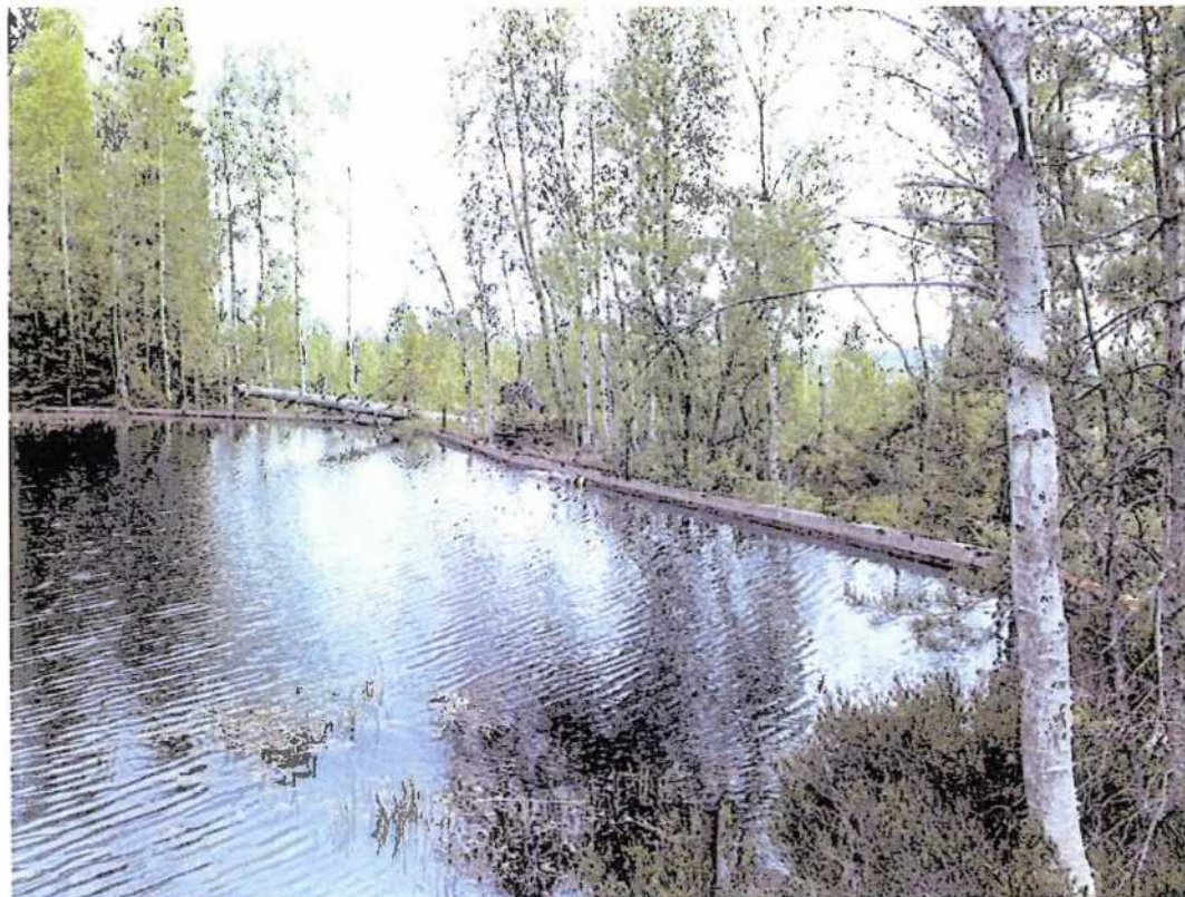
Øvre Askdam, juli 2009. Den lavere delen av dammen som har tydelige deformasjoner.
