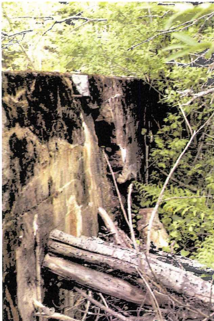
Midtre Askdam, juni 2009. Parti med betydelig avskalling og forskyvning.
