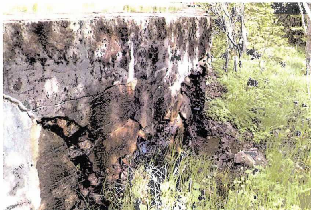
Midtre Askdam, juni 2009. Samme hjørne som ovenfor med betydelige sprekker og lekkasjer.
