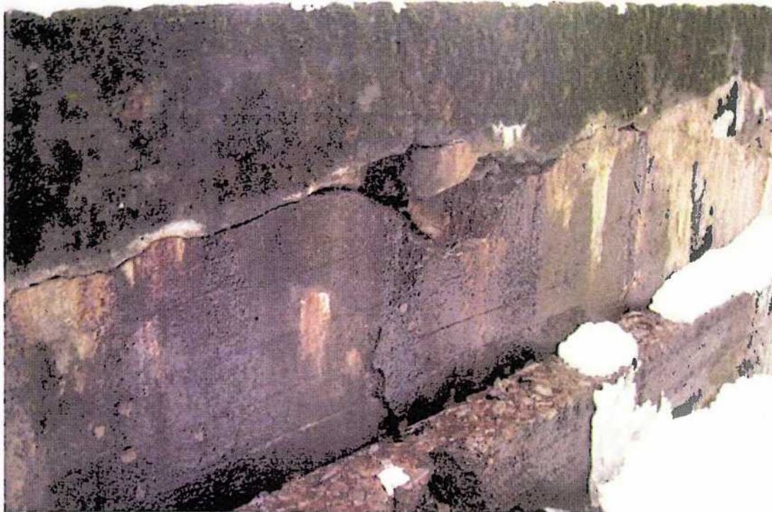
Midtre Askdam, desember 2009. Parti med avskallinger og markante sprekker.
