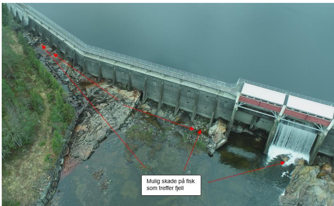
Figur 7. Venstre flomluke (sett medstrøms) leder vannet ned i fast fjell, mens ved høyre flomluke (sett medstrøms) ser det ut til å være en kulp med vanddyb. Langs hele overløpsdelen av dammen vil fisk kunne falle 6-10 m rett ned på fjellet.
