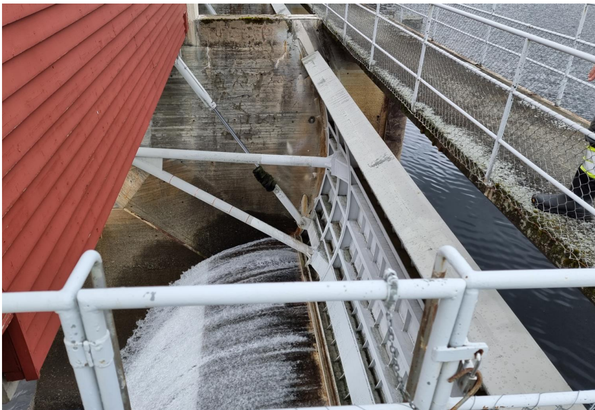
Figur 4. Segmentluke for flomavledning, tapping = 500 l/s ved magasinivannstand = 563,4 moh på befaringsstidspunkt.
