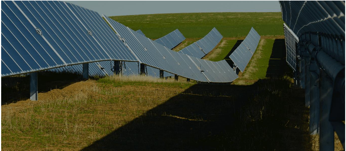
Figur 2-3. Illustrasjonsfoto som viser pæler, montasjestativer med motorer og solpaneler i skrå stilling. Foto fra NEXTracker.
