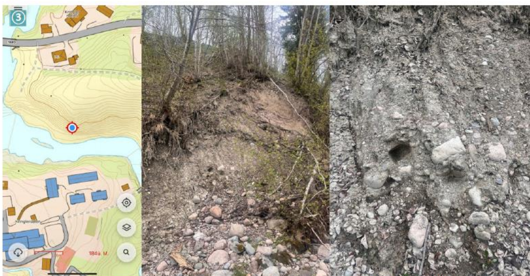
Figur 17: Observert overflateerosjon i nedre del av skråningen – elve- og bekkeavsetninger (3)
