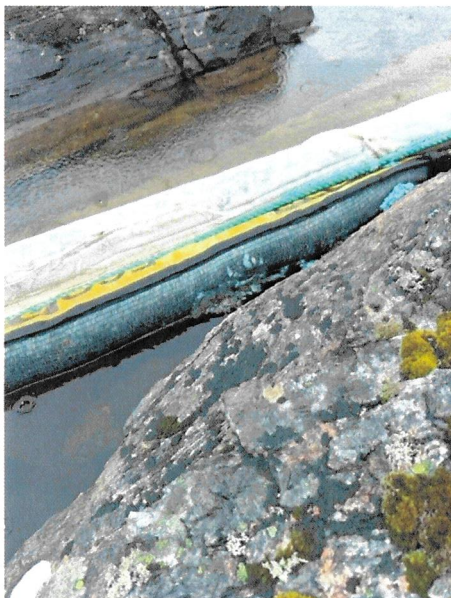
Bilde 07, Se skade på lense fra gnaging mot fjellet.
