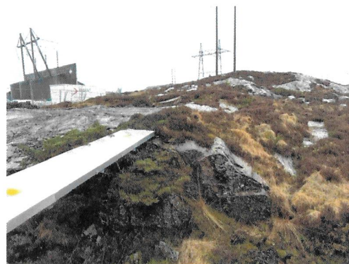
Bilde 08, Kabel med lite overdekning og kabelbro i rustfri plate.
