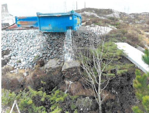
Bilde 09, Kabelbro og containere for filtrering
