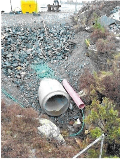
Bilde 01, Rør utløp - ikke vann i røret etter en natt med regn
