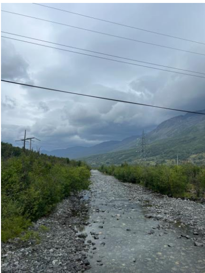
Figur 9-5 Strømmaster krysser elva ved trafostasjon
