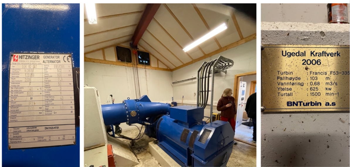
Figur 2-11 Turbin/generator i Ugedal kraftstasjon.
