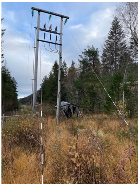
Figur 2-12. Påkoblingsmasta til TENSIO
