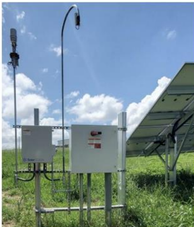
Figur 5-5. Illustrasjon av stativ med SCADA-system og meteorologisk stasjon
