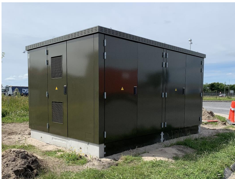
Figur 5-4. Illustrasjon av transformatoriosk.
