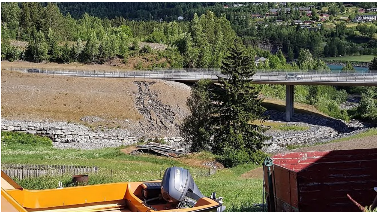
Bilde 69: Vegvann fra E6 har erodert på oppstrøms side av brua
