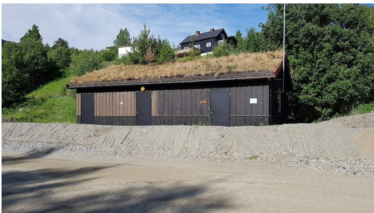
Bilde 76: Interkommunal pumpestasjon nedstrøms bilbru Klokkestranda
