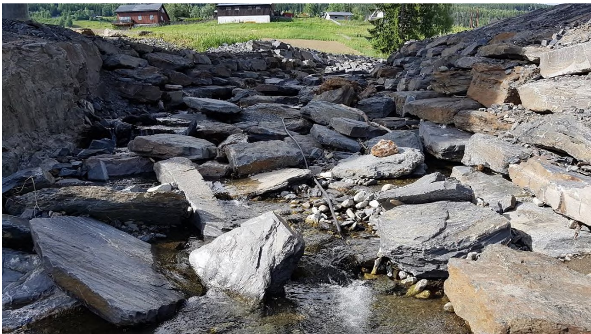
Bilde 72: Erosjonssikring under vegbru E6
