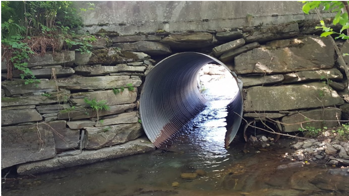
Bilde 63: Utløp vegkrysning Vintervegen
