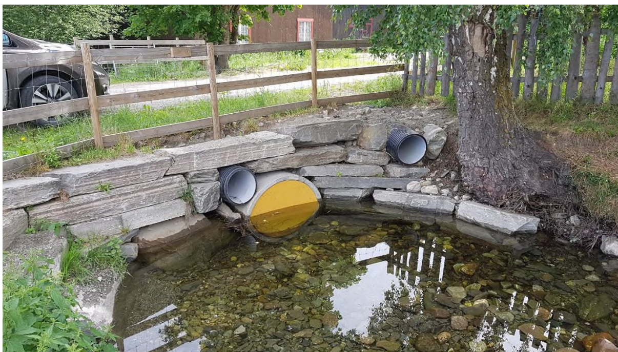
Bilde 85: Innløp med tett stikkrenne ved Sygard Skurdal
