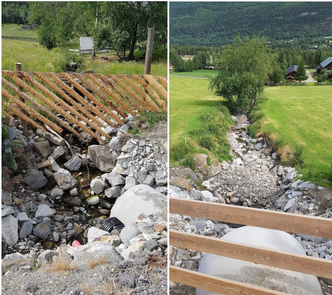
Bilde 84: Krysning av Baksidevegen, innløp til venstre og utløp til høyre
