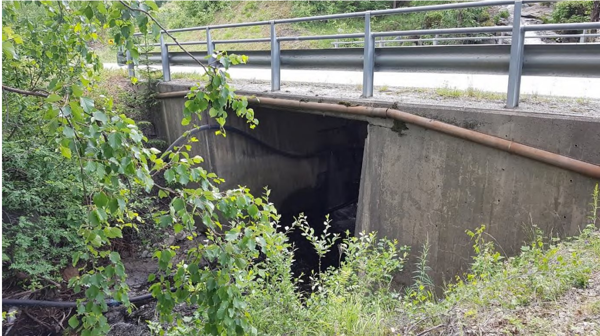
Bilde 49: Utløp kulvert vegkryssning Baksidevegen
