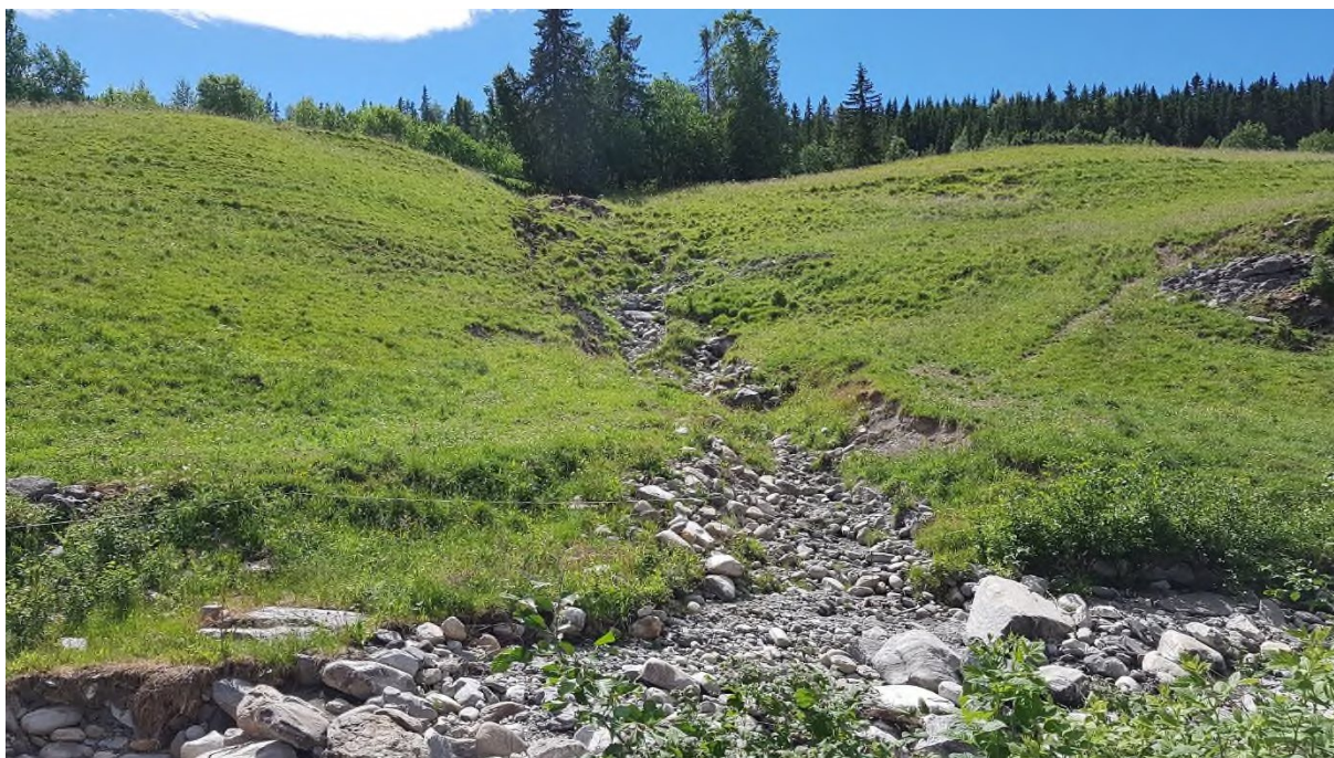
Bilde 92: Erosjonsskader fra sidebekk
