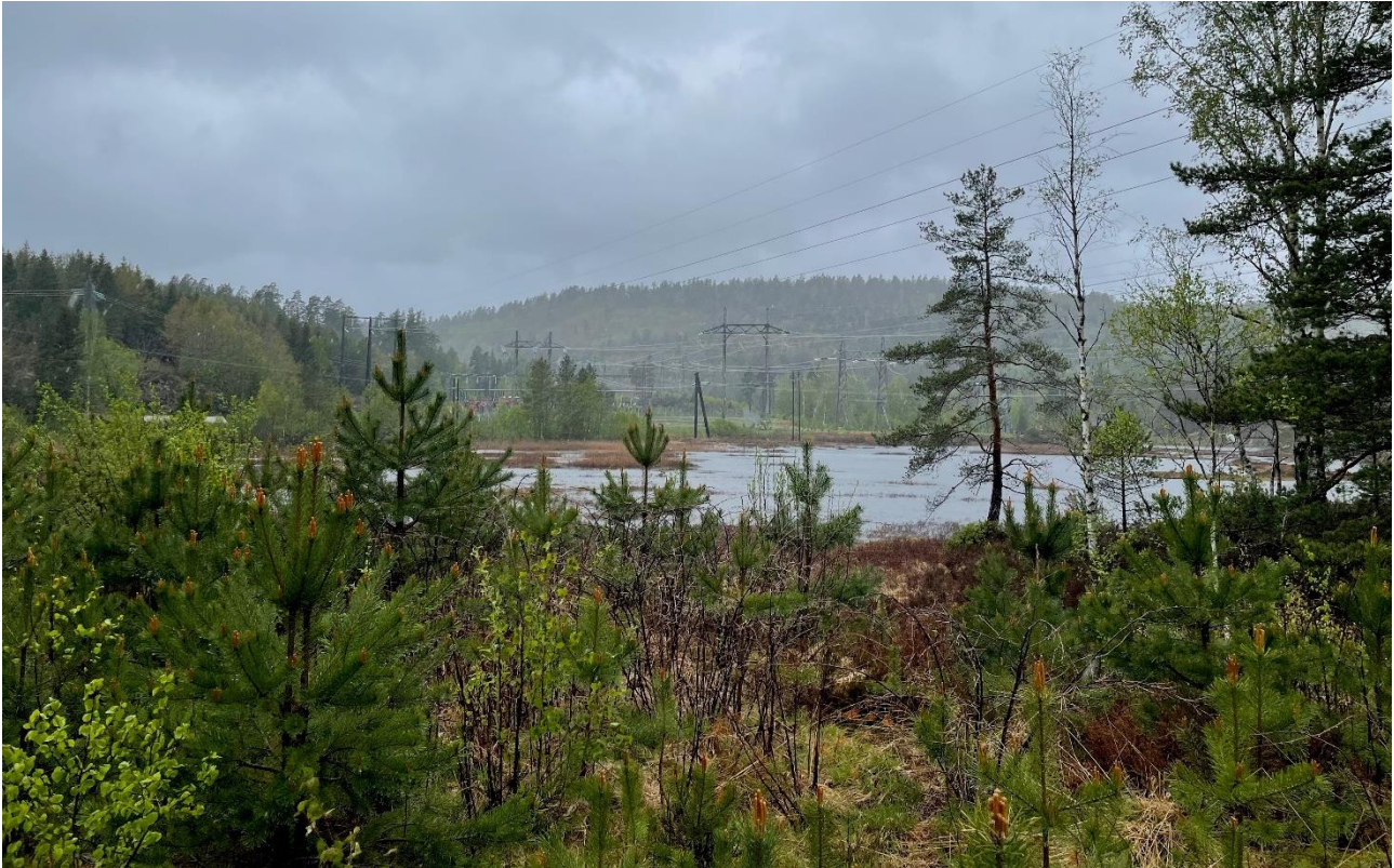
Figur 4-3. Monehagen transformatorstasjon sett fra grusveien som går videre til Arendal transformatorstasjon. Myrområdet og vannet som ses i forkant av stasjonen er en del av Mossevannet.
