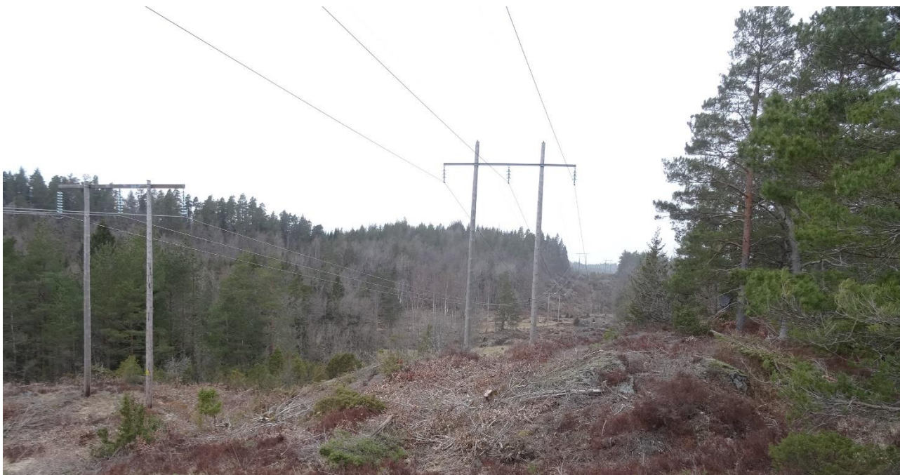
Figur 2-3. Foto av dagens to ledninger nord for Holtebekk. 132 kV til venstre i bildet.
