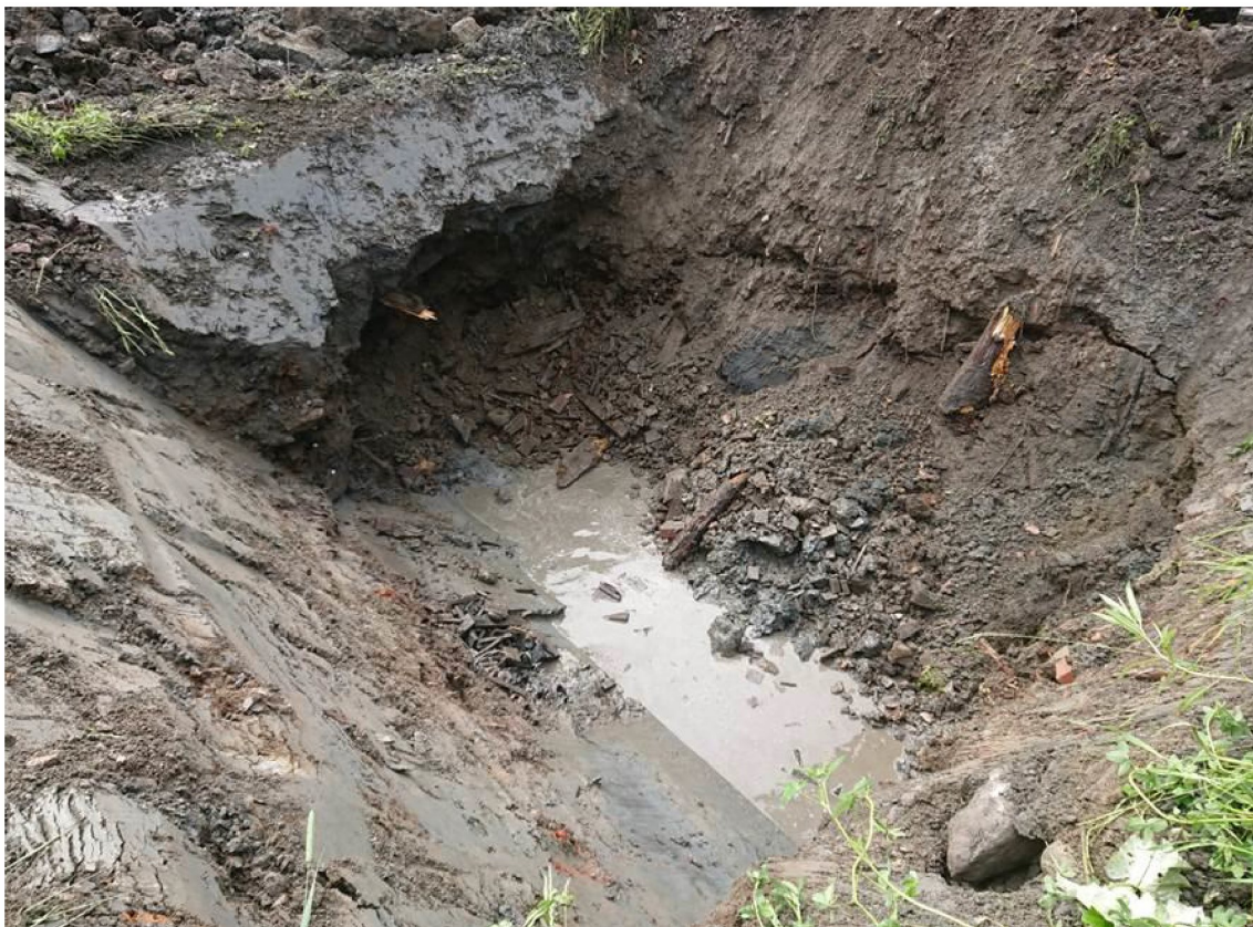
Figur 4: Sjakt nr. 3 avsluttet før traubunn på ny trasé pga. innstrøm av vann
