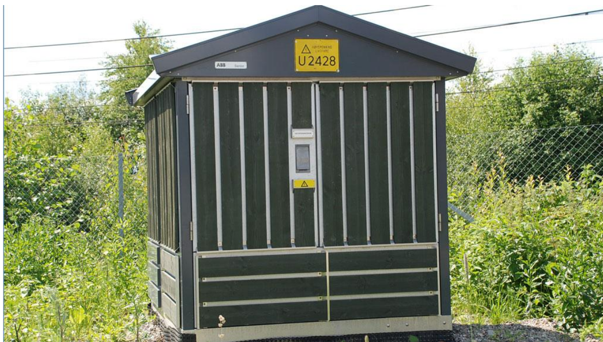
Figur 34 - eksempelbilde på nettstasjon som blir etablert rett i bakkant av kraftstasjon. (Bilde fra www.nek.no ) 7
