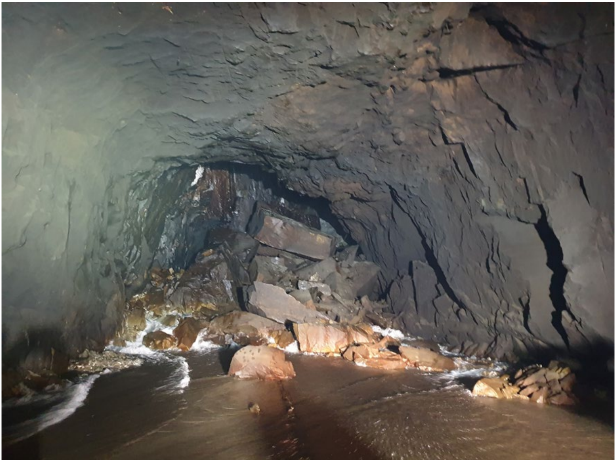
Figur 3-2 Ras i vannveien. Foto: Statkraft.
