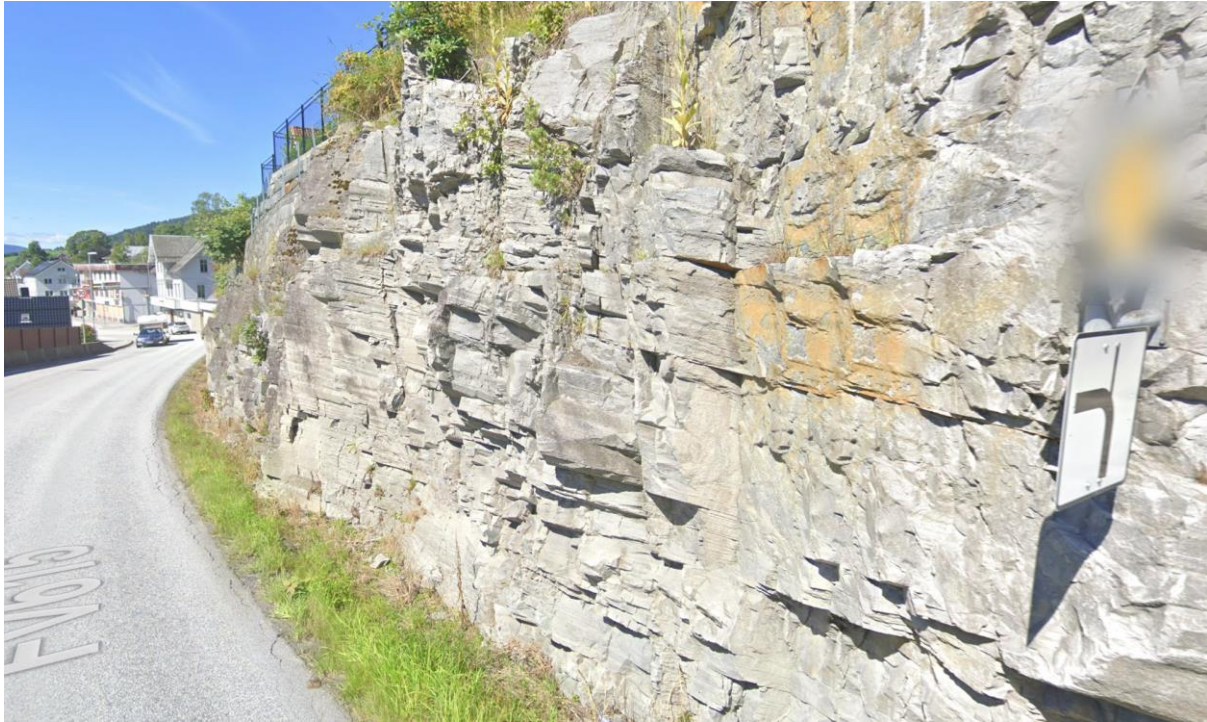
Figur 11 Bergskjæring langs Breimsvegen. (Kilde: google streetview, fra juli 2022, hentet: 05.03.2024)
