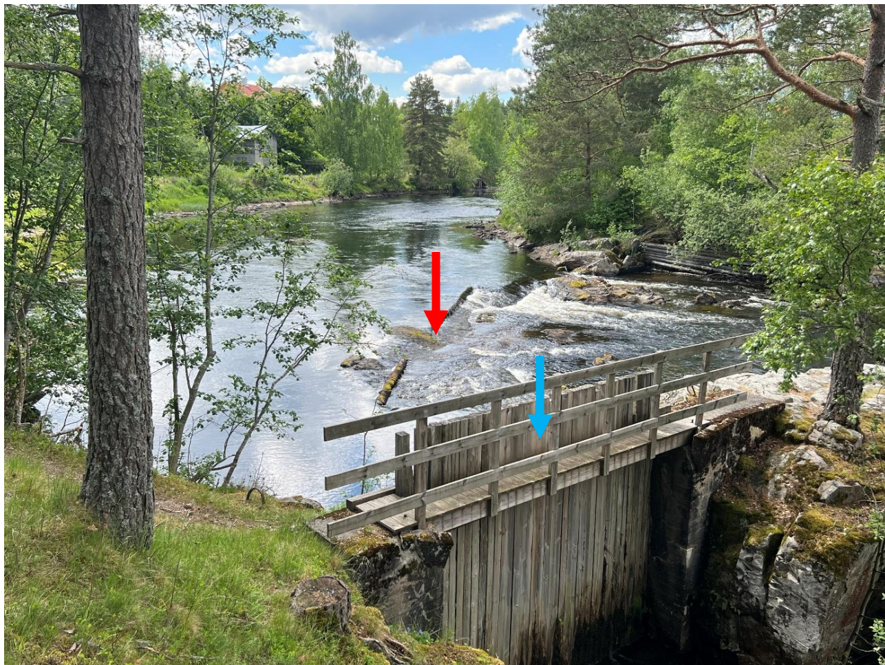
Raud pil viser eksisterande terskel i hovudelva / Bøelva (Teikning 140) Blå pil viser eksisterande tetting mot sideelv (Teikning 116)
