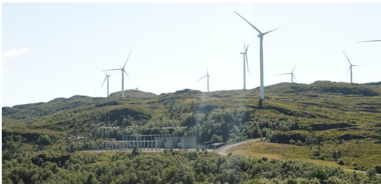
Figur 5-1 Transformatorstasjonen i Midtfjellet Vindpark.
