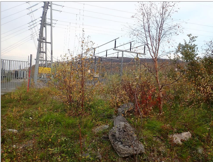
Figur 3-3. Bildet viser deler av trafostasjonen og høyspentledningen fra den. Foto: Sweco.
