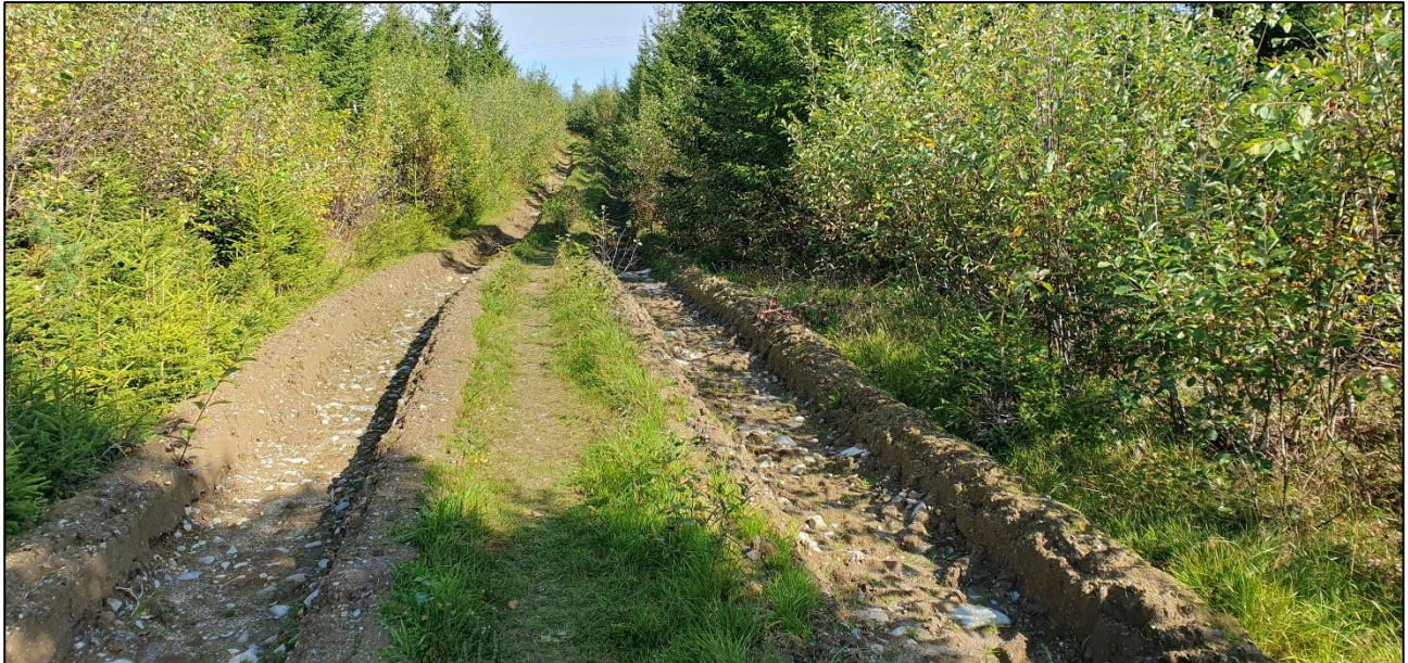
Figur 5-38: Traktorvei ødelagt av dype kjørespor i nordlig del av planområdet.
