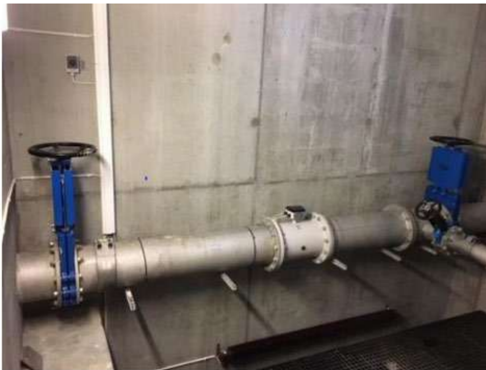
Figur 14. Bildet viser et minstevannføringsrør etablert med revisjonsventil til venstre, elektromagnetisk vannføringsmåler montert i en egen rørdel (hvit) og reguleringsventil for regulering av vannmengde til høyre i bildet. Foto: NVE
