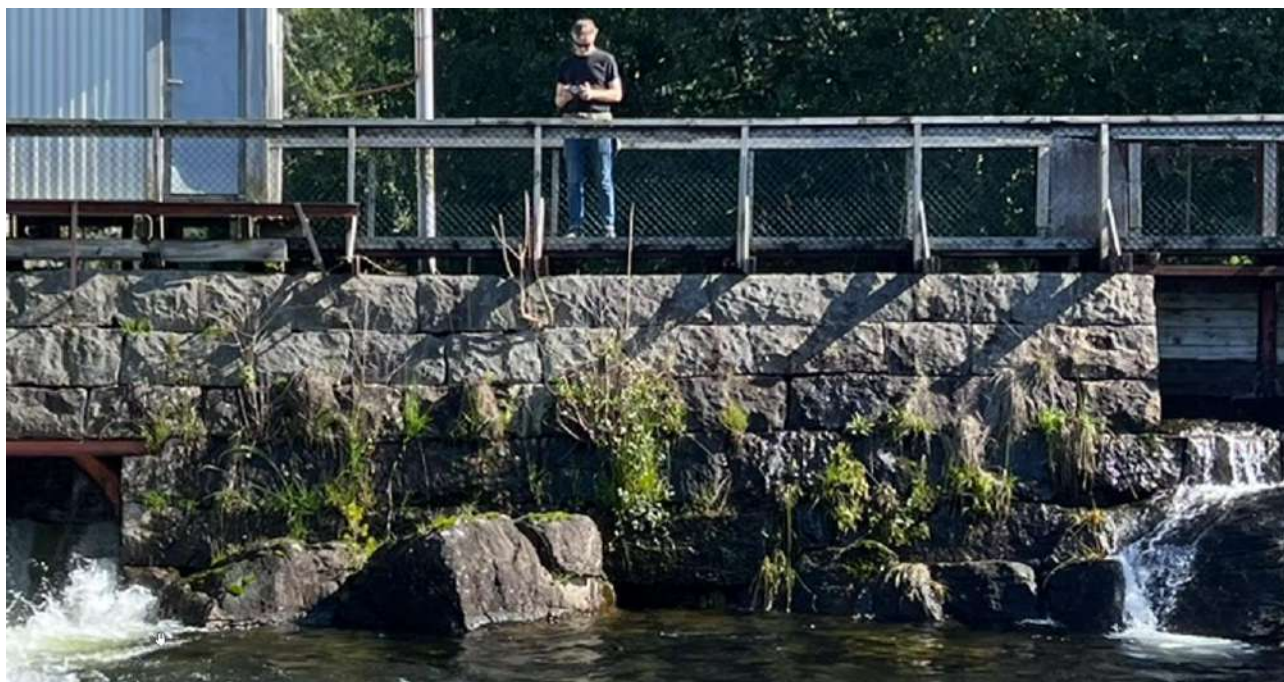
Figur 3-8: Bilde av dammen nedstrøm hvor muren er våt fra andre steinskift (tilsvarende vannstand på oppstrøms side) og ned til vannspeil.
