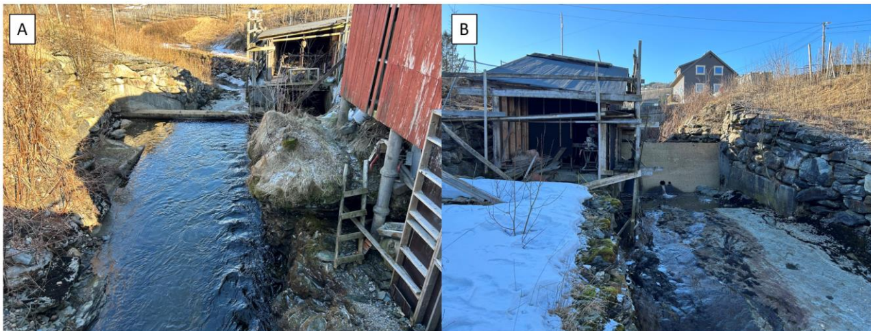
Figur 12: Bilder av dam Porkegjel, sett fra oppstrøms side (A) og fra nedstrøms side (B).
