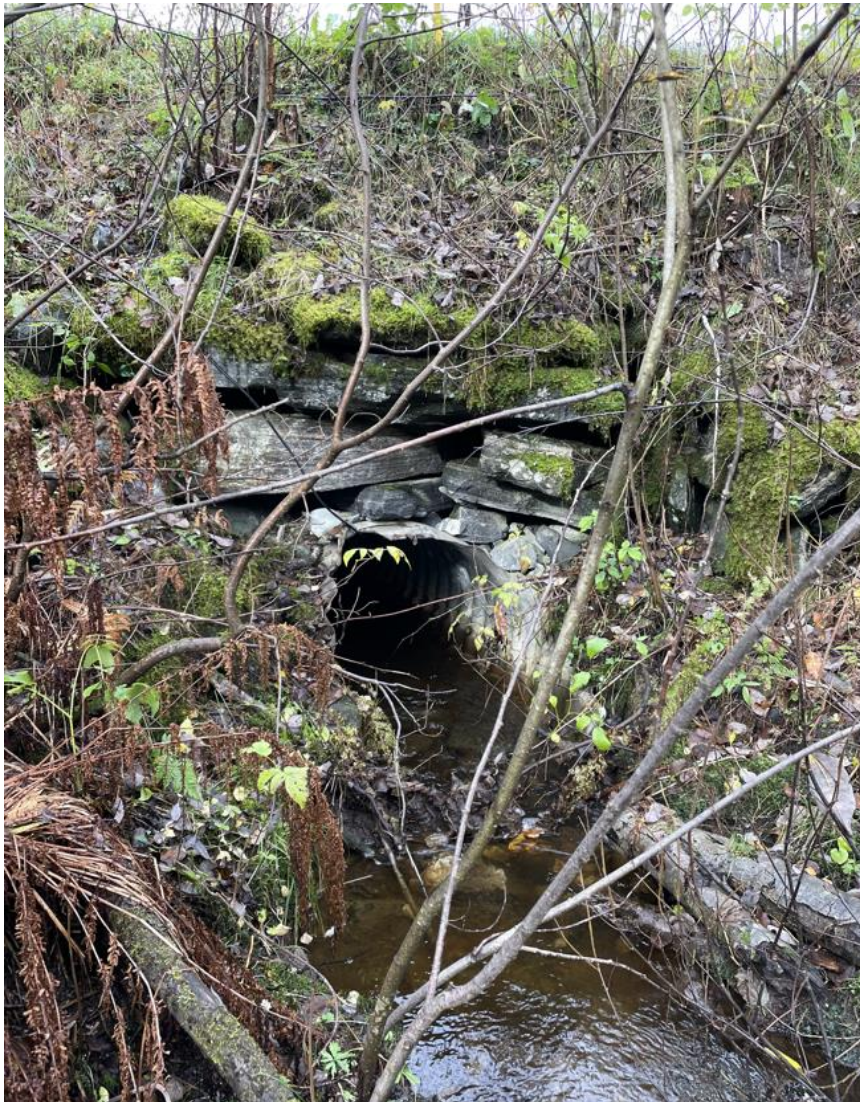
Figur 13: Stikkrenne under adkomstveg, innvendig diameter er 1 m.
