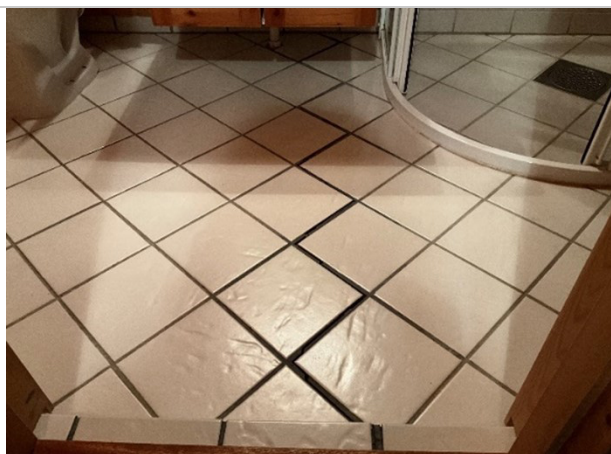
Bilde 11: Sprekk mellom flis i badet i underetasje. 2023.
