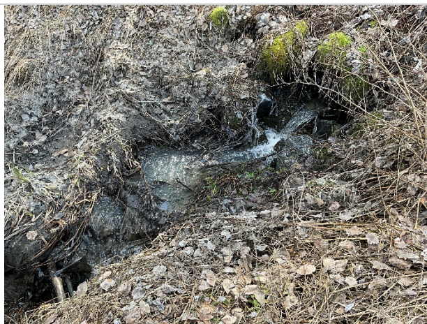
Bilde 35: Sideravine, med rør under skiløypa. Plastret med store stein nedenfor utløp av røret.
