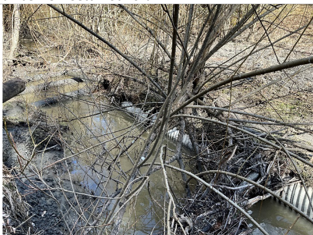
Bilde 30: Det er plassert tømmer i bekken (ligger også mange stokker oppå kanten), kanskje det var en provisorisk bro her tidligere. Det ligger også et stort rør i bekken, delvis tildekket av jord/busker. Bekken har erodert langs vestre bredd.
