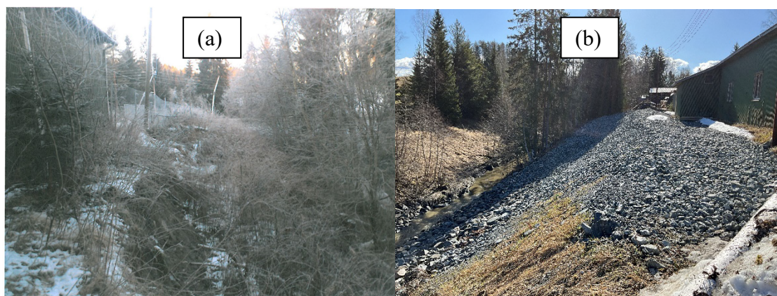
Figur 3-2 a) 04.12.2012: Utglidning sett fra øst - mot vaskehall og Egnerveien (ref. /15/), b) 16.04.2024 Steinplastring og fylling sett fra vest – mot vaskehallen.
