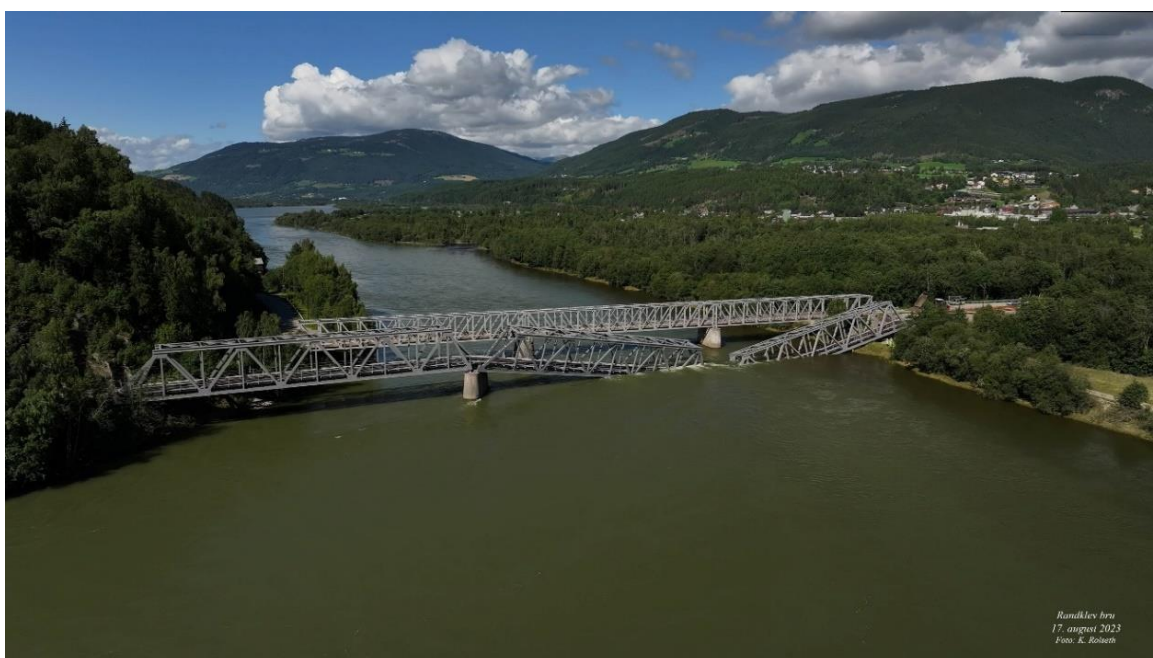
Figur 1-1. Dronebilde over tiltaksområde pr. 17. august 2023. Bildet viser Randklev jernbanebru etter kollaps, og vegbrua i bakgrunnen. Foto: Kjetil Rolseth.
