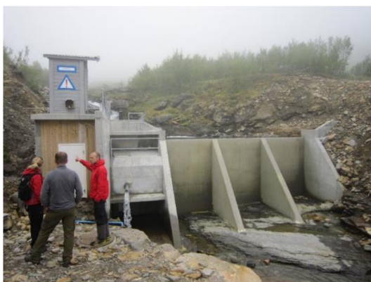
Figur 5. Bildet viser slipp av minstevannføring på 30 l/s gjennom rør via inntaket. Foto: NVE
