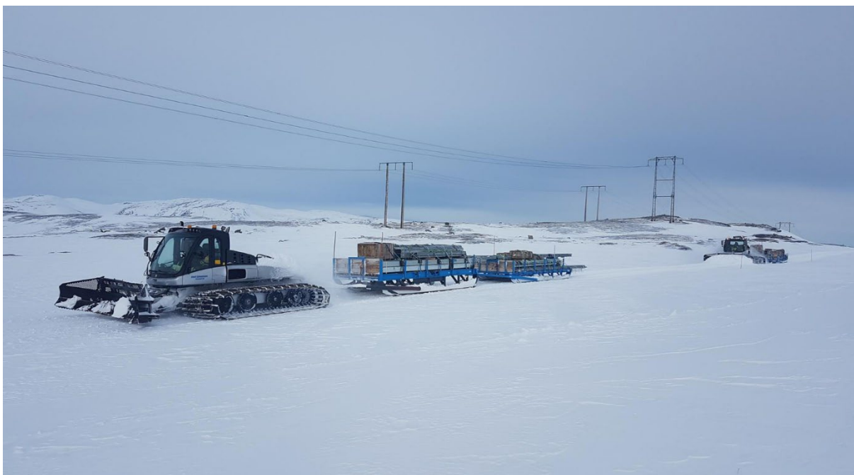
Figur 17: Vintertransport av mastemateriell. Her fra bygging av ny 420 kV ledning mellom Balsfjord og Skillemoen.
