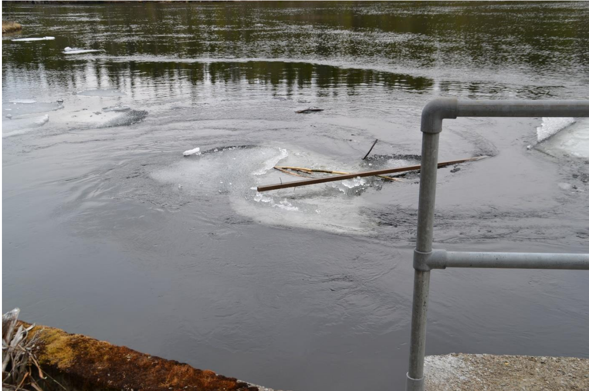
Det er ingen form for avskjerming mot terrenget til høyre for tunnelinntaket. Bilde av 22.05.2018.
