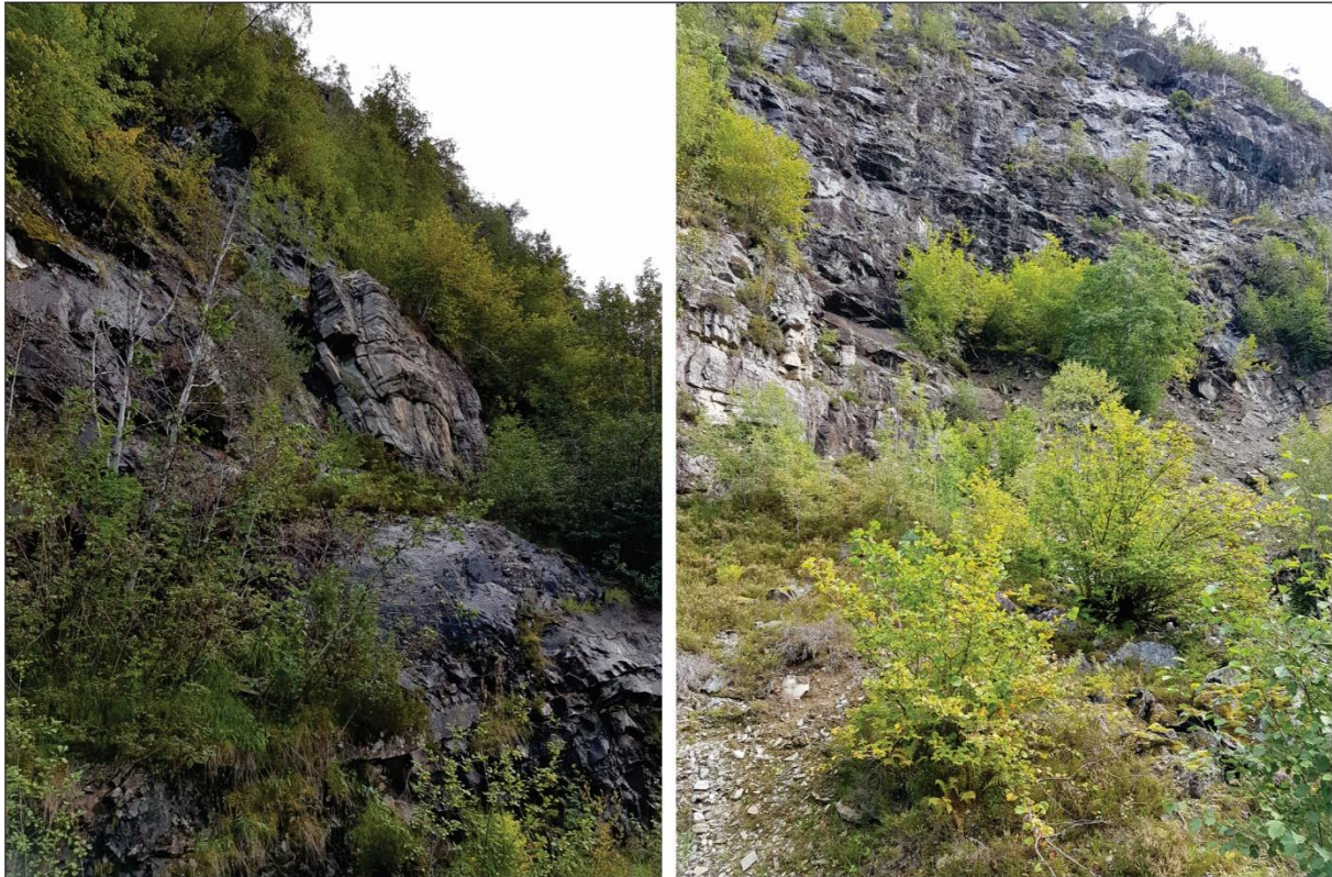
Figur 10: Bilete av fjellskjeringa og fjellhammaren ovanfor sørlege del av det kartlagde området. Like ovanfor øvste vegen direkte ovanfor gabionmuren.
