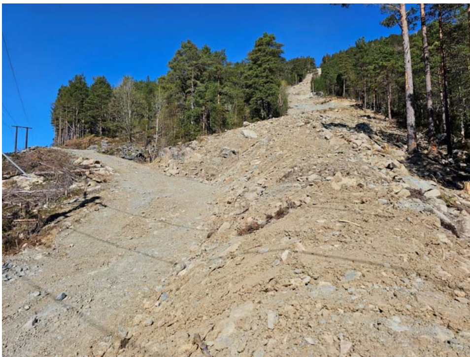
Bilde 6: Rørtras rett ovenfor kraftstasjon. Bilde fra 2023 når anlegg nettopp var ferdig.
