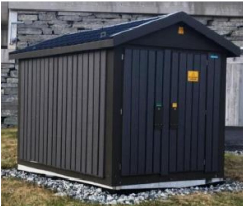
Figur 4: 22 kV Skagen nettstasjon
