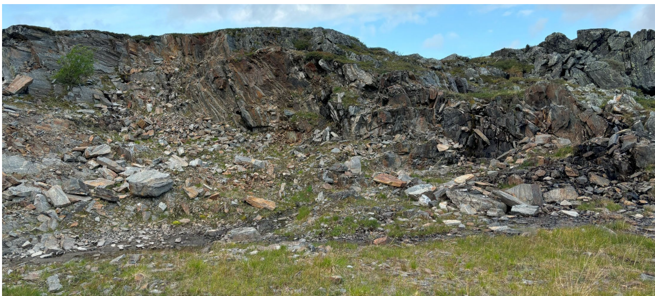
Figur 10: Eksempel på deformert bergmasse i starten av anleggsvegen.
