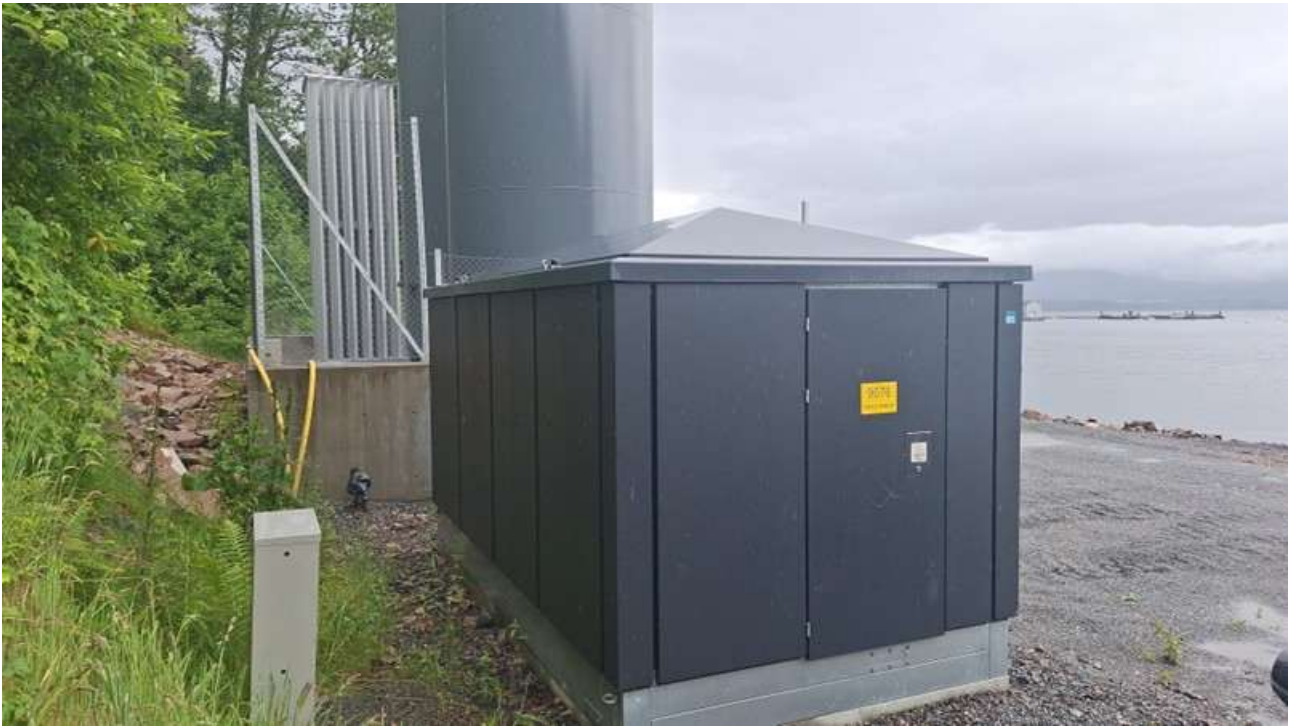
Figur 7: Pre-fabrikkert nettstasjon Sekken.
