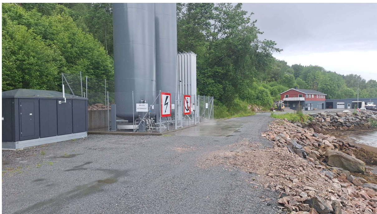
Figur 15 Oversiktsbilde kabeltrase fra sjø til nettstasjon.
