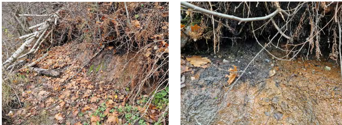
Figur 3 Bakkant av utglidning lengst nedstrøms på eiendommen. Foto fra befaring 17.11.2022
