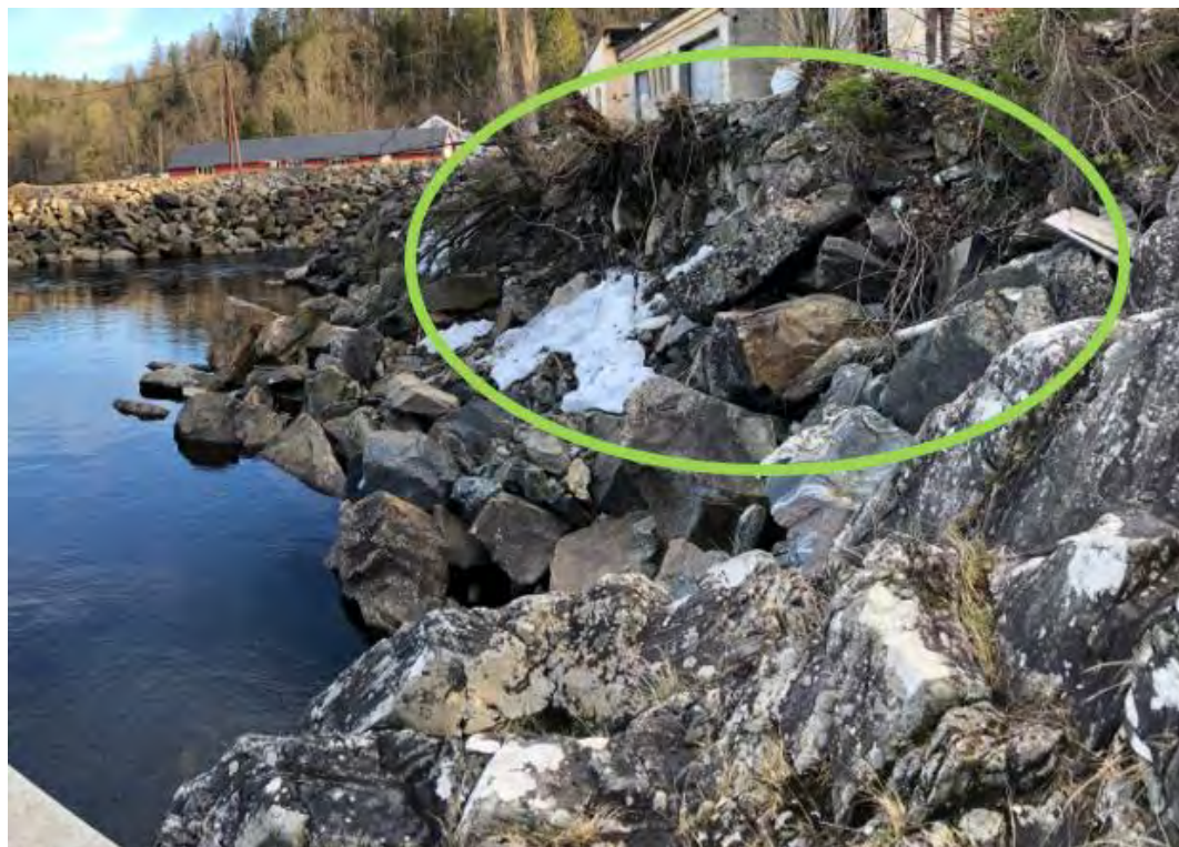
Fig 18 Erosjon i elvekanten straks nedstrøms nedre terskel.
