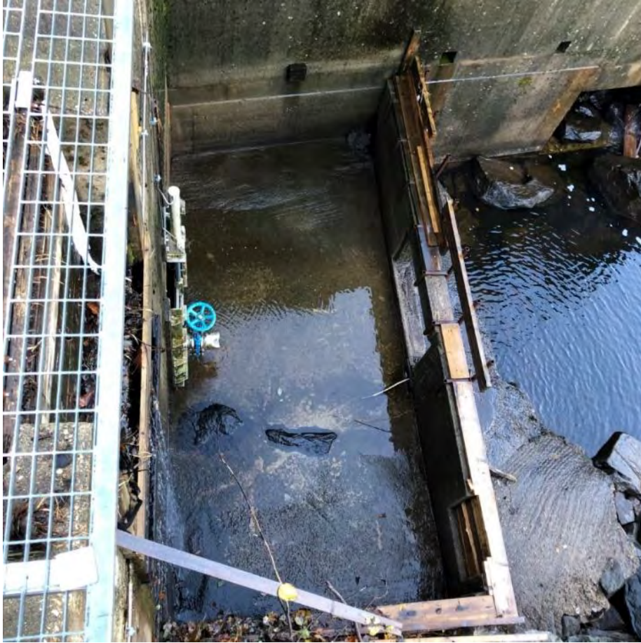
Figur 5 Eksisterende betongkum ca. skal rives og erstattes med sigmoid-formet betongnedløp. Teknisk utrustning på betongveggen som tilhører dagens åleluke skal fjernes og denne lukeåpningen støpes igjen. Kulpen til høyre er kulpen nedstrøms dammen som tar imot vannet fra fikeluka via sigmoid nedløp.
