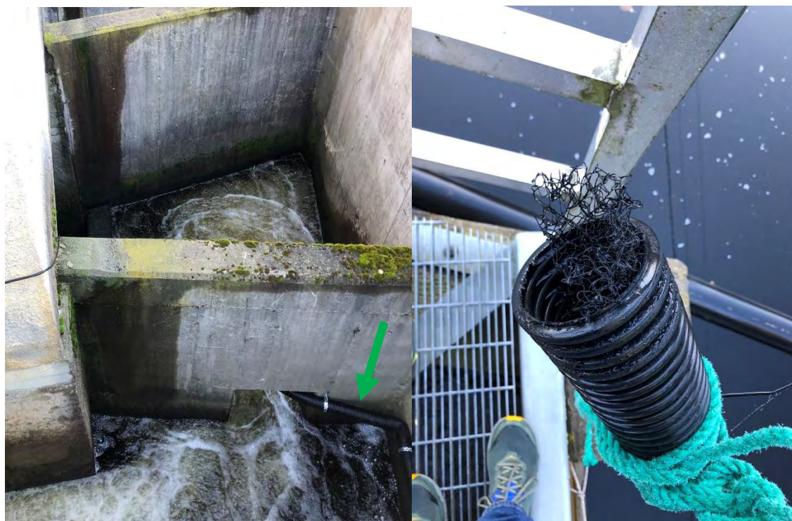
Figur 11 Vandringsrør for ålefaring er montert i fisketrappa. Røret er fylt med encamat som ålefaringene klatrer i.
