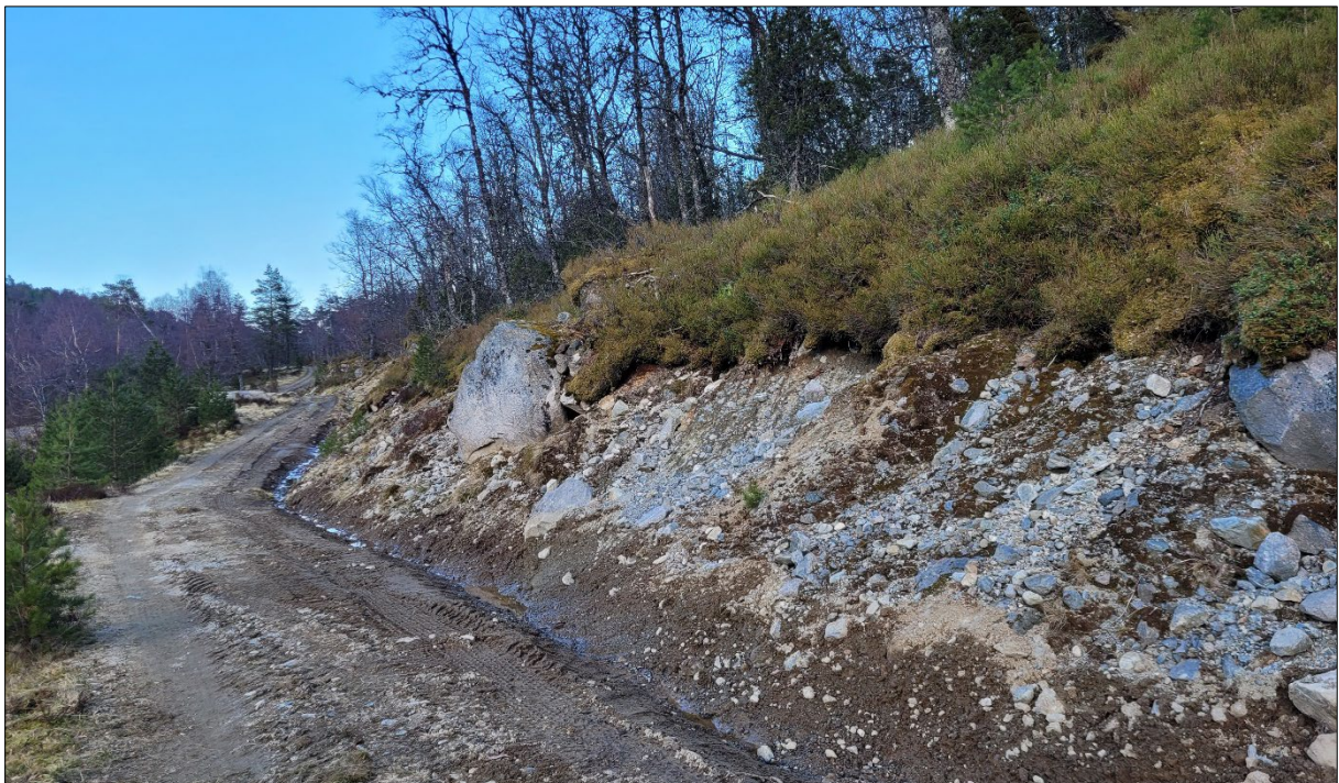
Figur 30: Eksponert lausmasseskråning ovanfor nausta, vest i kartlagt område. Det er vurdert at drenering som blir leia ned mot dette området kan føre til ustabilitet i lausmassane og små utrasingar, hovudsakleg direkte nedanfor renneforma ved infopunkt 7.
