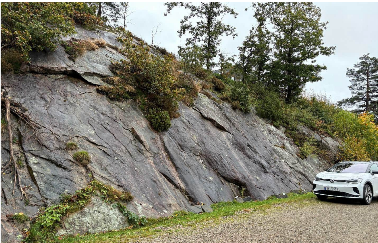
Bilde 4: Infopunkt 2 i Vedlegg 4. Bergskrent/glattskurt svaberg, med enkelte tilsynelatende avløste flak og blokker i størrelsesorden ca. 0,2-0,5 m 3 . Sett mot sørøst.
