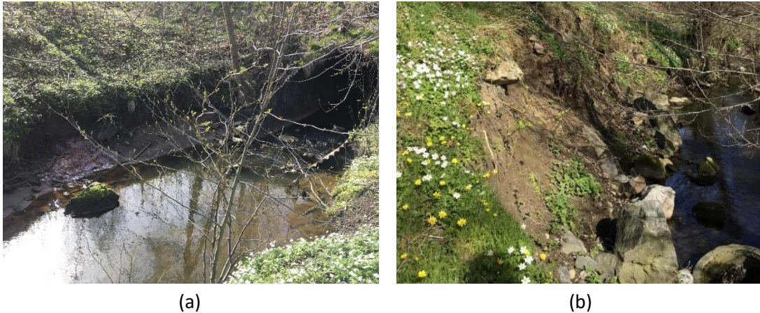
Figur 64 Fotografier fra befaring i området ved Ekornveien: (a) erosjon i bekk, (b) erosjon og utglidning under bebyggelsen.
