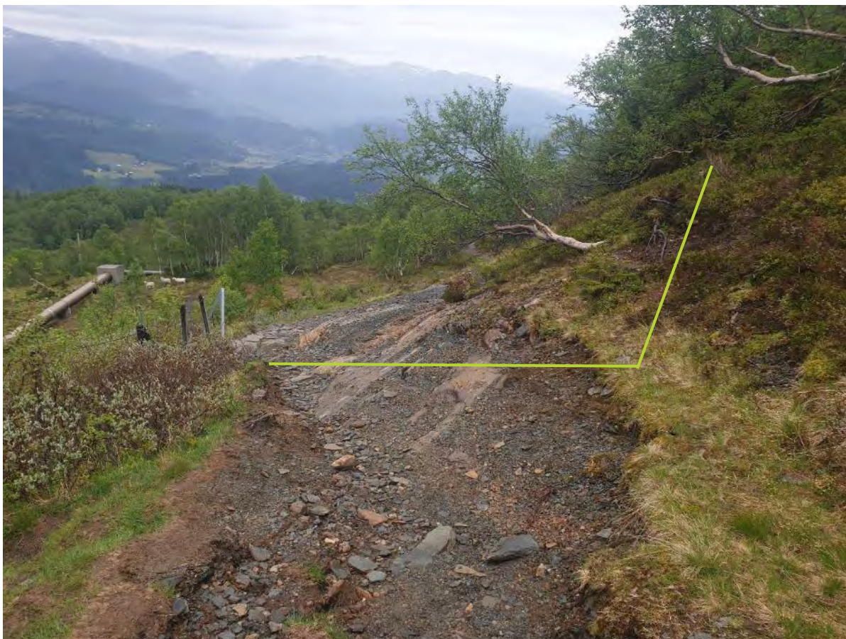
Figur 21 Stien her må utbedres ved forsiktig sprenging eller pigging for en bredere trasé.
